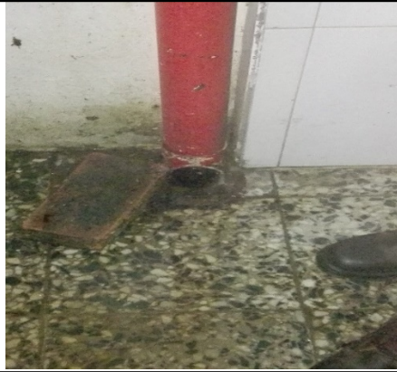
Foto No. 3. Tubería de agua lluvia con adecuación para recepción de agua residual no doméstica generada en actividades de lavado de instalaciones, equipos, utensilios y áreas.
