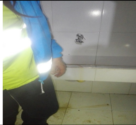
Foto No. 4 Sello impuesto en llave área de vestier segundo nivel
