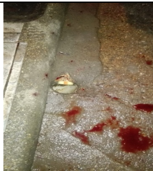
Foto No. 7 Presunta tubería de agua lluvia procedente de segundo nivel con descarga de agua residual no doméstica generada del lavado de áreas, utensilios, equipos e instalaciones.
