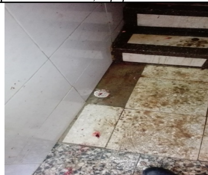
Foto No. 8 Escurrimiento de agua residual no doméstica desde el segundo nivel hacia la calle y sifón anterior a puerta de salida.
